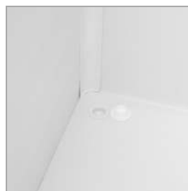
Desagüe de descongelación
